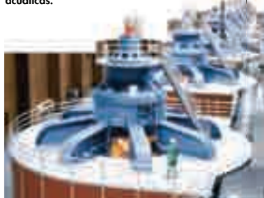
Generadores como este producen la electricidad en las centrales hidroeléctricas Chilenas.
